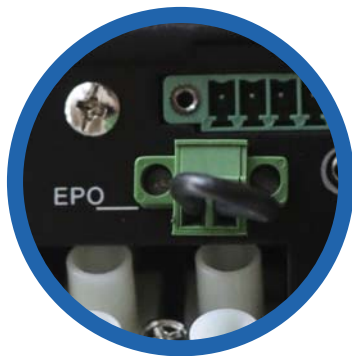
Apagado de Emergencia (EPO)
